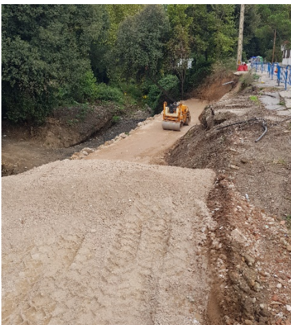
Mur de gabions a tocar de la riera i ampliació d'avinguda Castellví. Setembre 2020.
