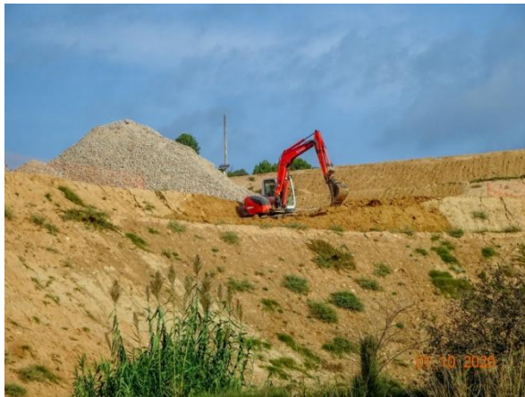
La superfície, constituïda per àrids procedent de les excavacions a cop de maquinària pesada no constitueix un sòl apte per al desenvolupament de la vegetació.
